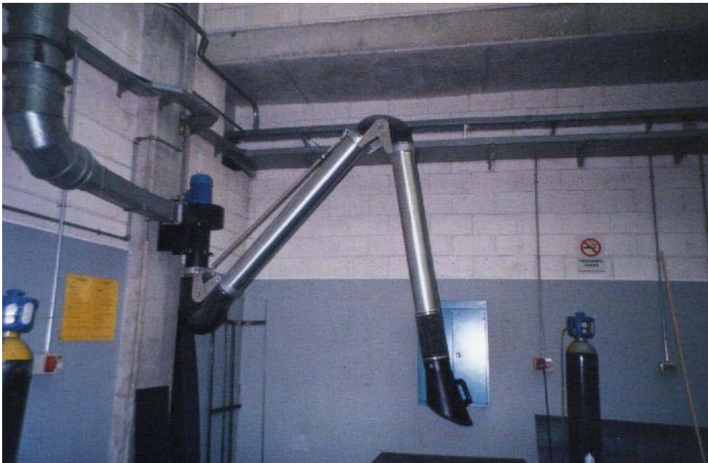
Figura 14. Boca móvil de aspiración de humos de soldadura
